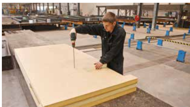
Stap 1: Voorboren van gaten in de isolatie voor het insteken van de Thermoanker staven.
