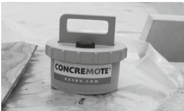
Geplaatst Concremote® systeem
