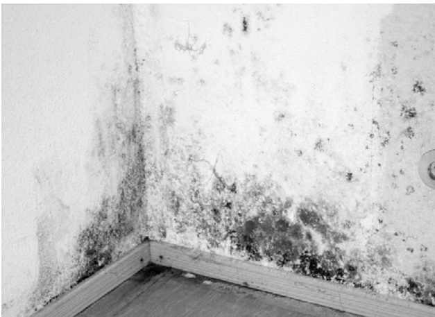
Afb. 5: Voorbeeld van schimmelvorming in een hoek
